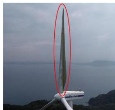
7号風車:ブレード1枚破損
