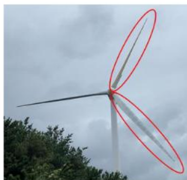
16号風車:ブレード2枚破損
